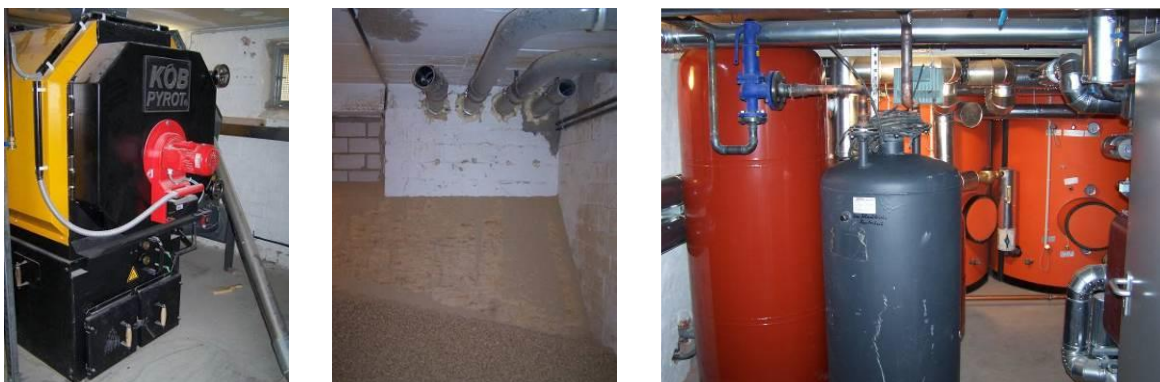
Bild 250 Holzpelletkessel, Pelletlager, Einbausituation Pufferspeicher, Ausdehnungsgefäß und Nachspeisebehälter
