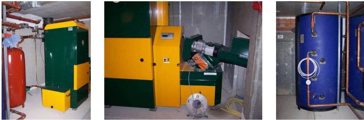
Bild 264 Einbausituation Holzpelletkessel und Pufferspeicherkaskade Heizzentrale Brentanostr.
