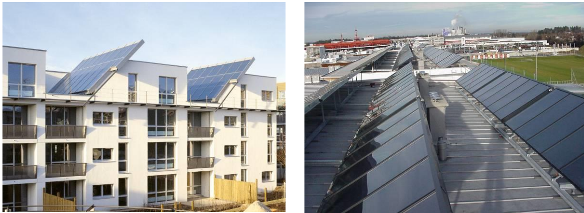
Bild 245 Beispiele für Kollektorfelder mit guter Zugänglichkeit für Wartungs- und Instandsetzungsarbeiten
