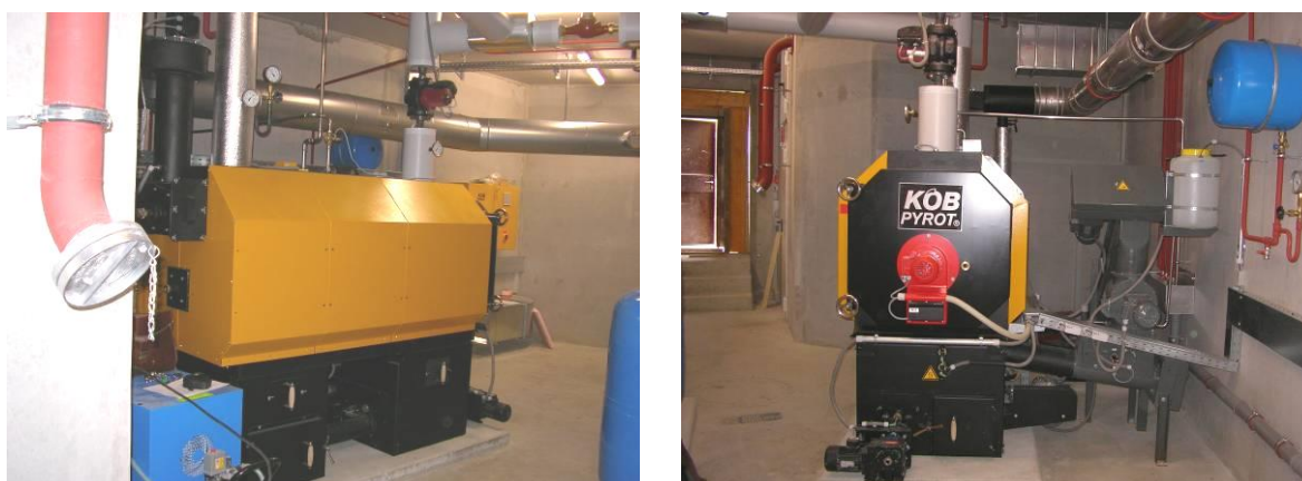
Bild 237 Einbausituation Holzpelletkessel in der Heizzentrale
