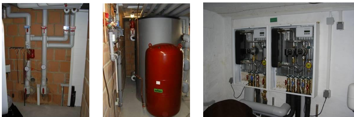
Bild 258 Nahwärmenetzaustritt Heizzentrale, Ausdehnungsgefäß Nahwärmenetz, Frischwasserstationen
