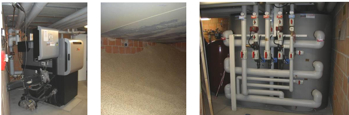
Bild 257 Holzpelletkessel, Pelletlager, Einbausituation Pufferspeicher 1 und 2
