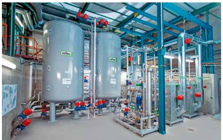
Die neue Druckhalteanlage des Heizwerks „Im Grund“
