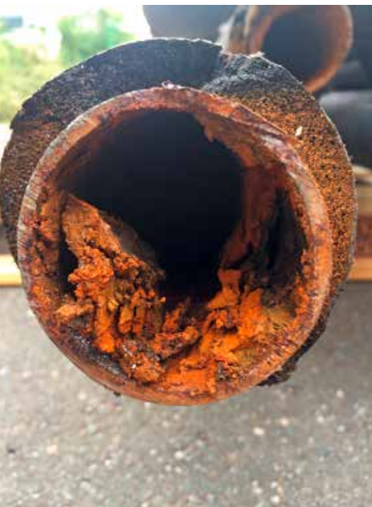
Abbildung 1: Inkrustationen im 20 Jahre alten Kühlwasserrohr Foto: BROCHIER
