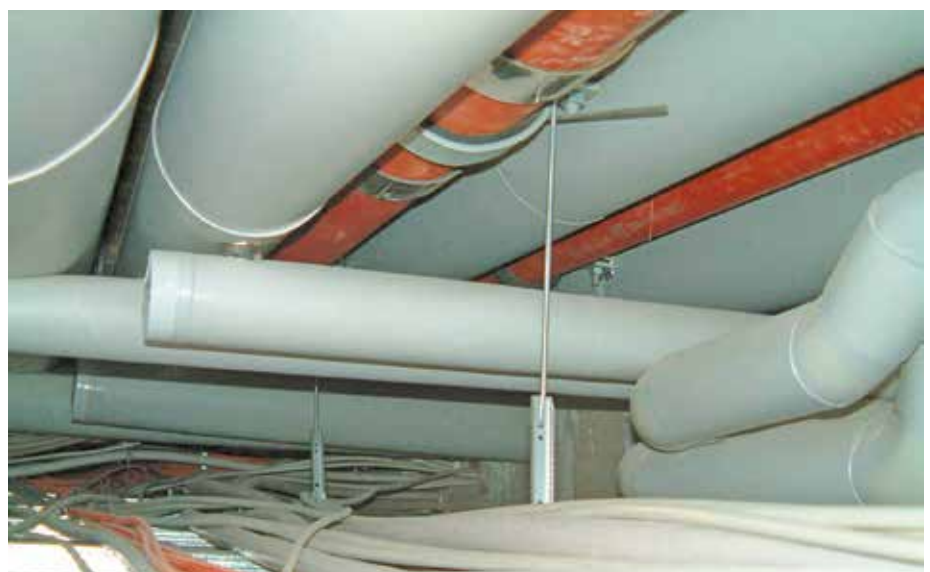
Abbildung 1: Zwischendeckenbereich mit hoher Installationsdichte und geringen Abständen zur Unterdecke Foto: Hilti Deutschland AG
