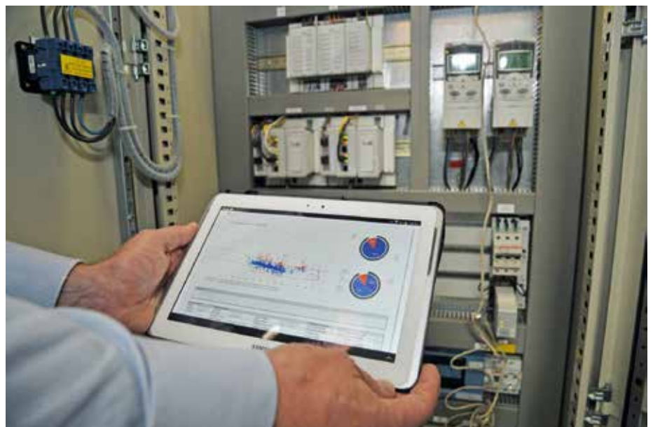
Monitoring-Tools bieten einen detaillierten Einblick in sämtliche Prozesse rund um den Betrieb von gebäudetechnischen Anlagen. Foto: Priva Building Intelligence GmbH
