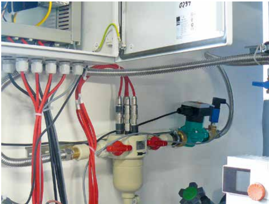
Abbildung 3: Mit sauerstoffdiffusionsdichtem Edelstahl-Wellschlauch angebundene Korrosions-Messstrecke mit Datenlogger und DFÜ-Schaltschrank Foto: SIZ energie+
