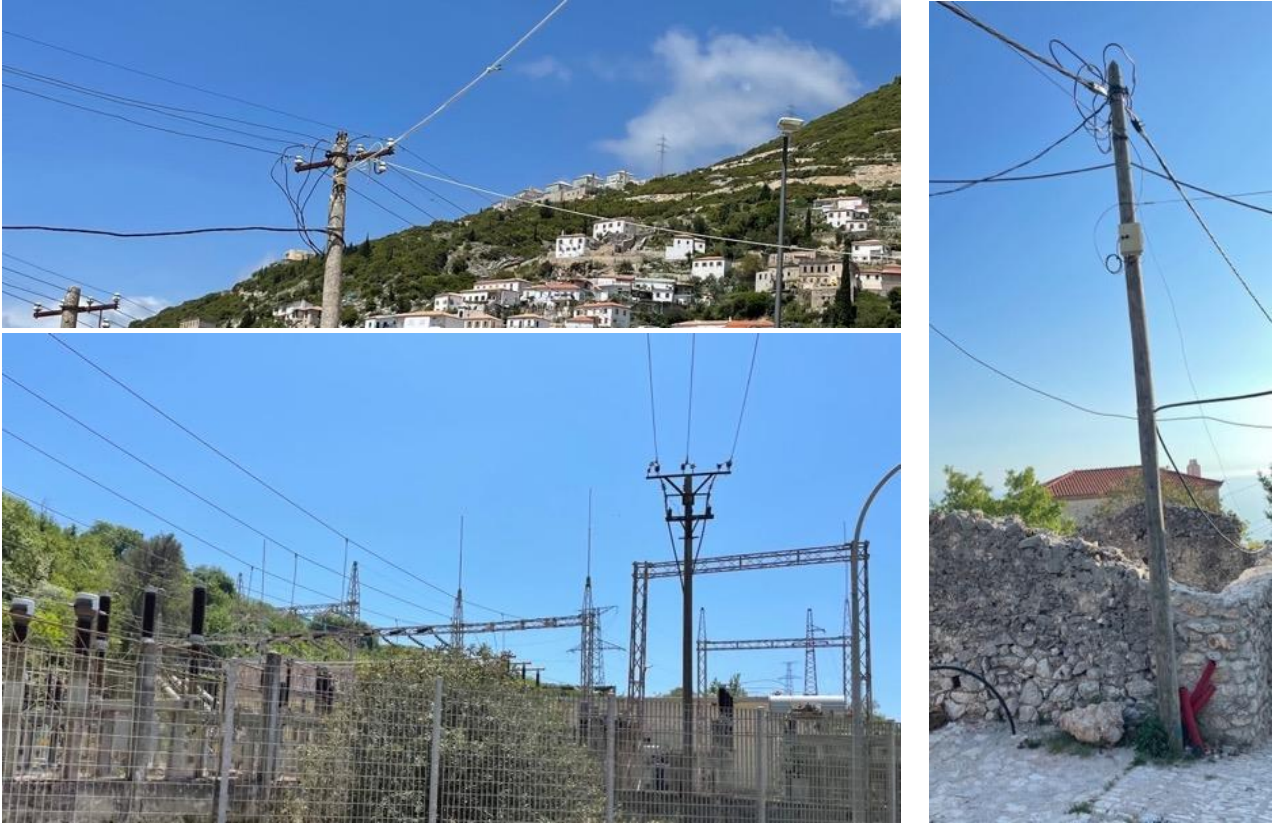
Abbildung 22 Impressionen des Stromnetzes – Umspannwerk Himare (links unten) Quelle: Goduni International GmbH
