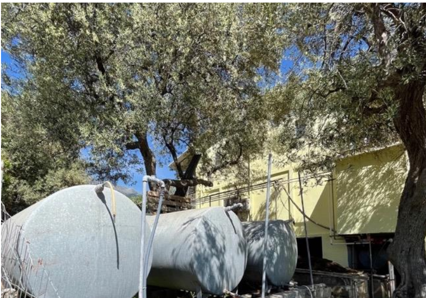
Abbildung 23 Solarthermie und Wassertanks in Dhërmi Quelle: Goduni International GmbH, 2021
