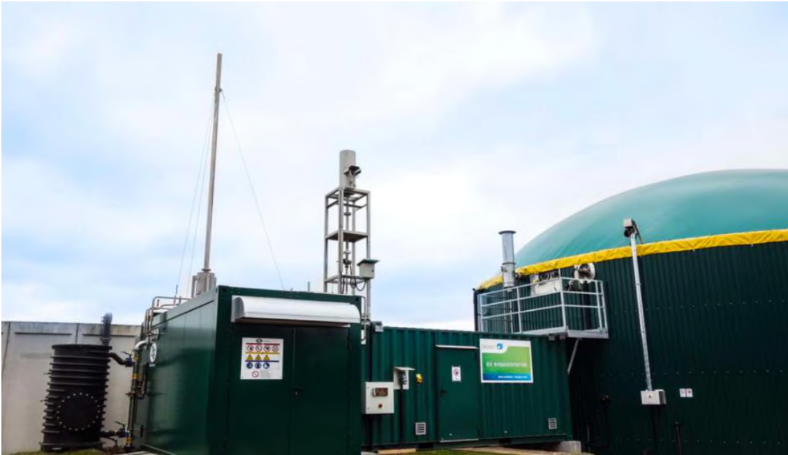
Abbildung 95: Biogasanlage-Beispiel 1 Quelle: Goduni International GmbH - Ökobit GmbH
