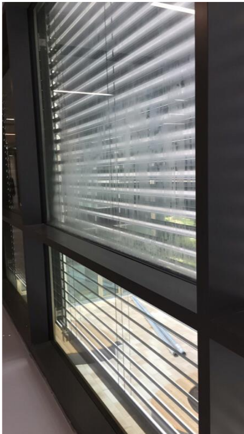
Abbildung 41: Kondensation im Scheibenzwischenraum als Indiz für einen vorliegenden Defekt
