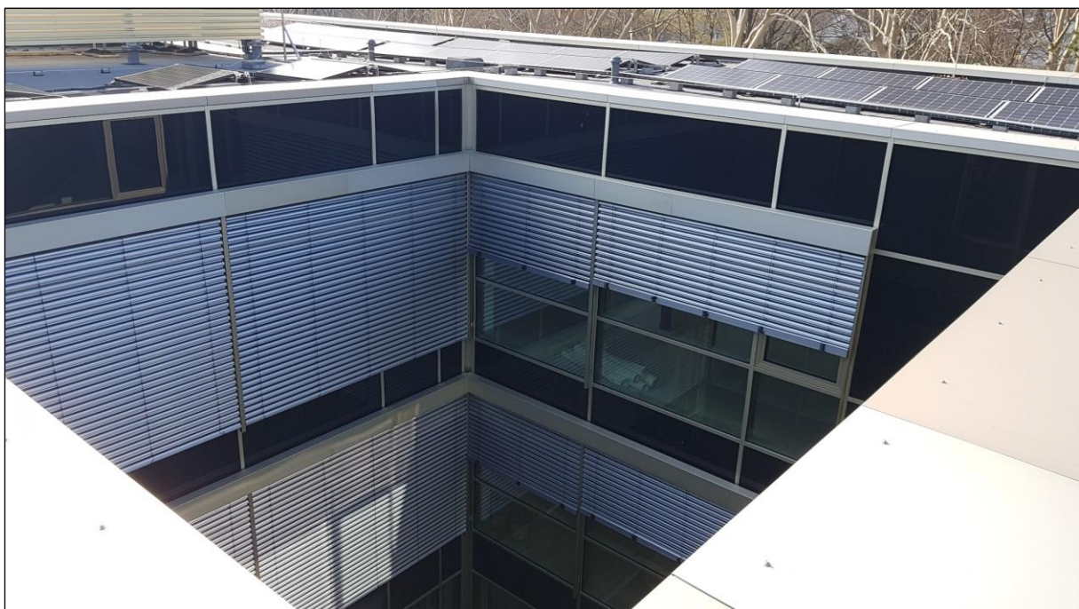
Abbildung 44: Unterschiedliche Stellung nach einem zentralen Stellbefehl
