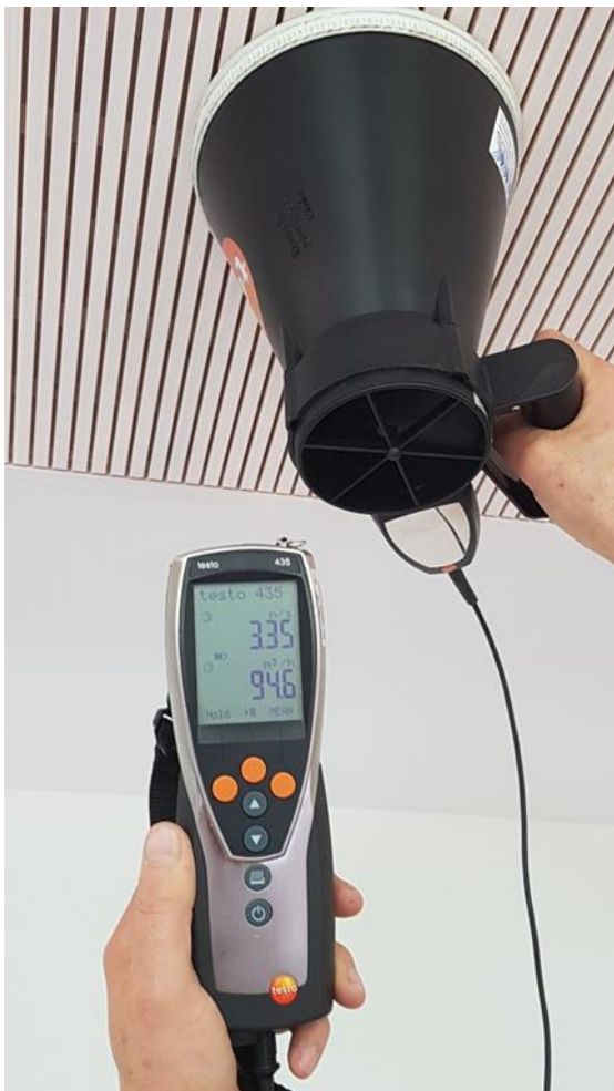
Abbildung 6: Luftmengenmessung mit einem Flügelradanemometer und Trichteraufsatz, Quelle: energydesign braunschweig GmbH
