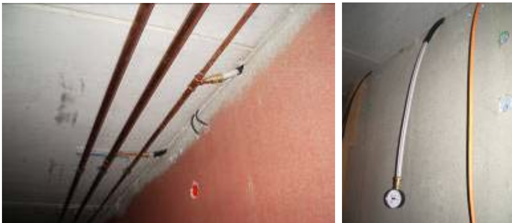
Abbildung 53 Etagenverteilung für die Betonkernaktivierung (rechts mit Manometer zur Leckageüberwachung während des Betoniervorgangs)
