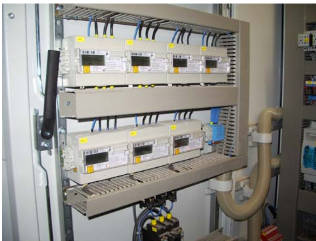
Abbildung 117 Beispiel der Einbausituation der Stromzähler im Schaltschrank
