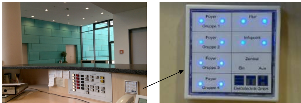
Abbildung 76 Kontrollpanel des Pförtners für Lüftung und Beleuchtung (nachträglich installiert)
