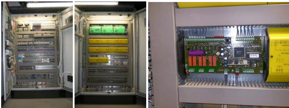
Abbildung 29 Schaltschränke und Automationsstation (Abdeckung entfernt)
