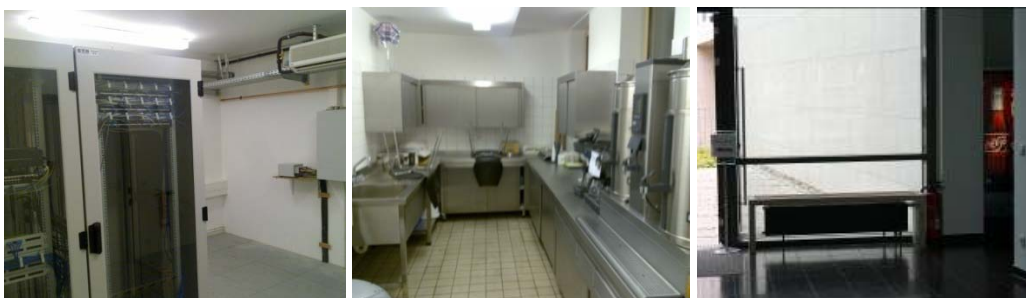
Abbildung 28 Umluftkühlgerät in einem EDV-Raum (links), Cateringküche (mitte), Getränkeautomat im Foyer (rechts)
