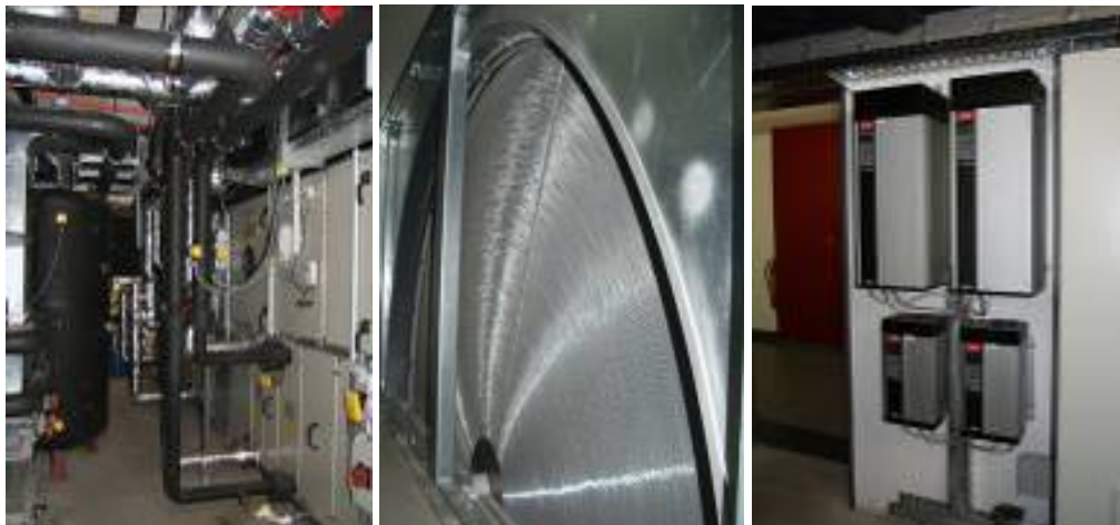
Abbildung 61 Lüftungsanlage Multifunktionsbereich, Wärmerad (Regenerator), Frequenzumformer (oben)
